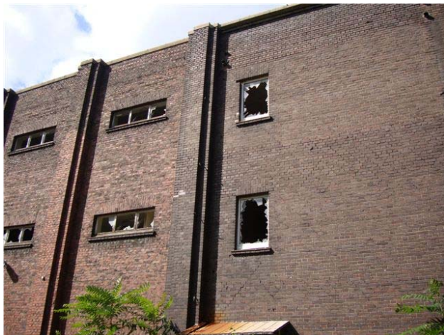
Abbildung 18: Fensterscheiben sind eingeschlagen, die Verkleidung der Dachkanten fehlt.
