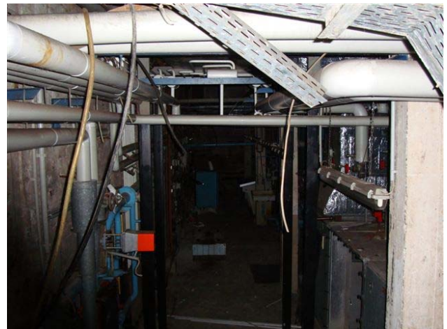
Abbildung 13: Die Technik im Keller ist teils herausgerissen.
