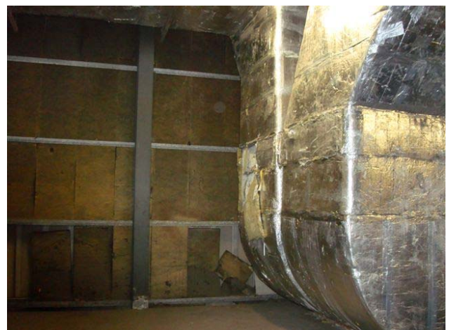
Abbildung 6: Durch Schäden in der Fassade ist das Dachgeschoss und sein Treppenhaus stellenweise nach außen offen.
