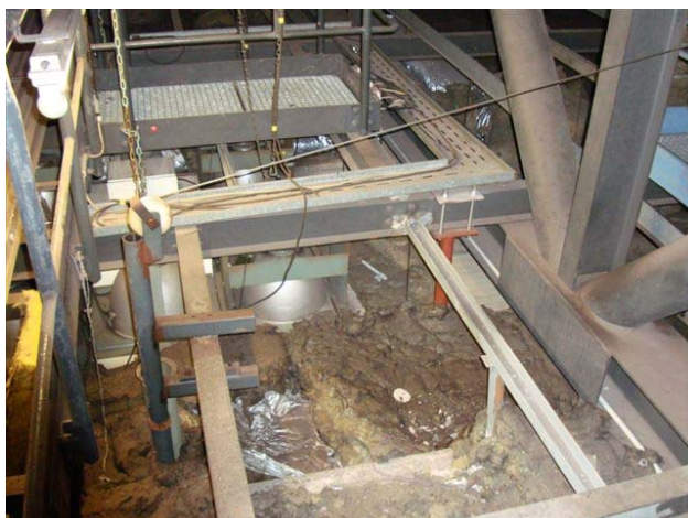
Abbildung 5: Das Dachgeschoss ist mit Trägern, Röhren und Isolierung sehr unübersichtlich.
