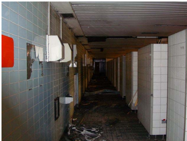
Abbildung 14: In den Innenräumen, hier den Umkleidekabinen, sind Deckenplatten defekt und Installationen herausgerissen.
