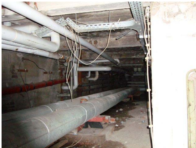
Abbildung 12: Große Teile des Kellers sind von teils defekten Kabeln und Röhren durchzogen
