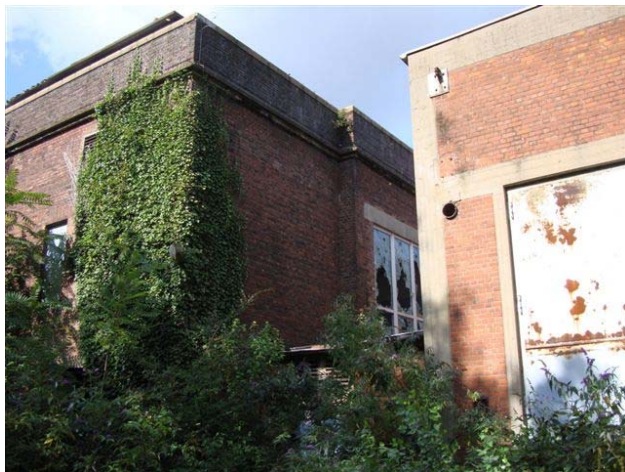
Abbildung 3: Das Hallenbad ist baulich in desolatem Zustand und teils zerfallen.
