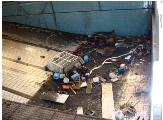
Abbildung 15: In Schwimmbecken liegt Müll und Reste der umgebenden Einrichtung.
