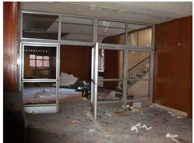
Abbildung 4: In Inneren des Hallenbades sind überall Spuren von Vandalismus und Diebstahl zu sehen.
