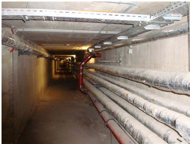
Abbildung 9: Der Kriechkeller mit Rohrleitungen.
