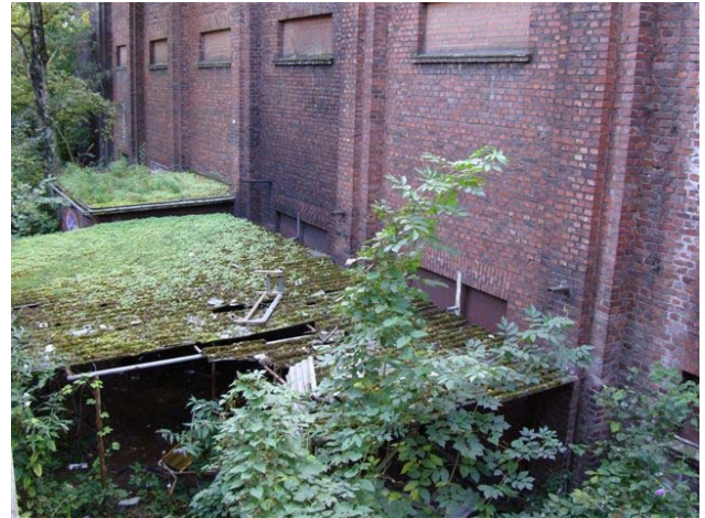
Abbildung 17: Die Unterstände im Innenhof sind von Pflanzen überwachsen und teils eingestürzt.
